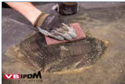
148. Reinigen der beschädigte Stelle.
